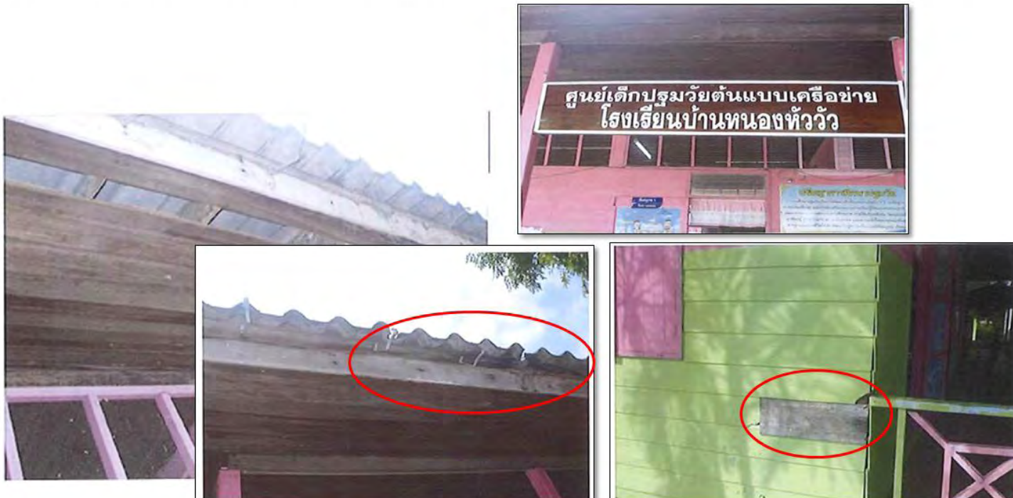
สภาพอาคาร รร.บ้านหนองหัววัว ที่ชำรุดทรุดโทรม เนื่องจากก่อสร้างมานาน
